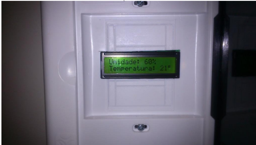
Figura 6 - Montagem do Arduino em uma caixa de disjuntor elétrico, exibindo a leitura do sensor DHT11.
